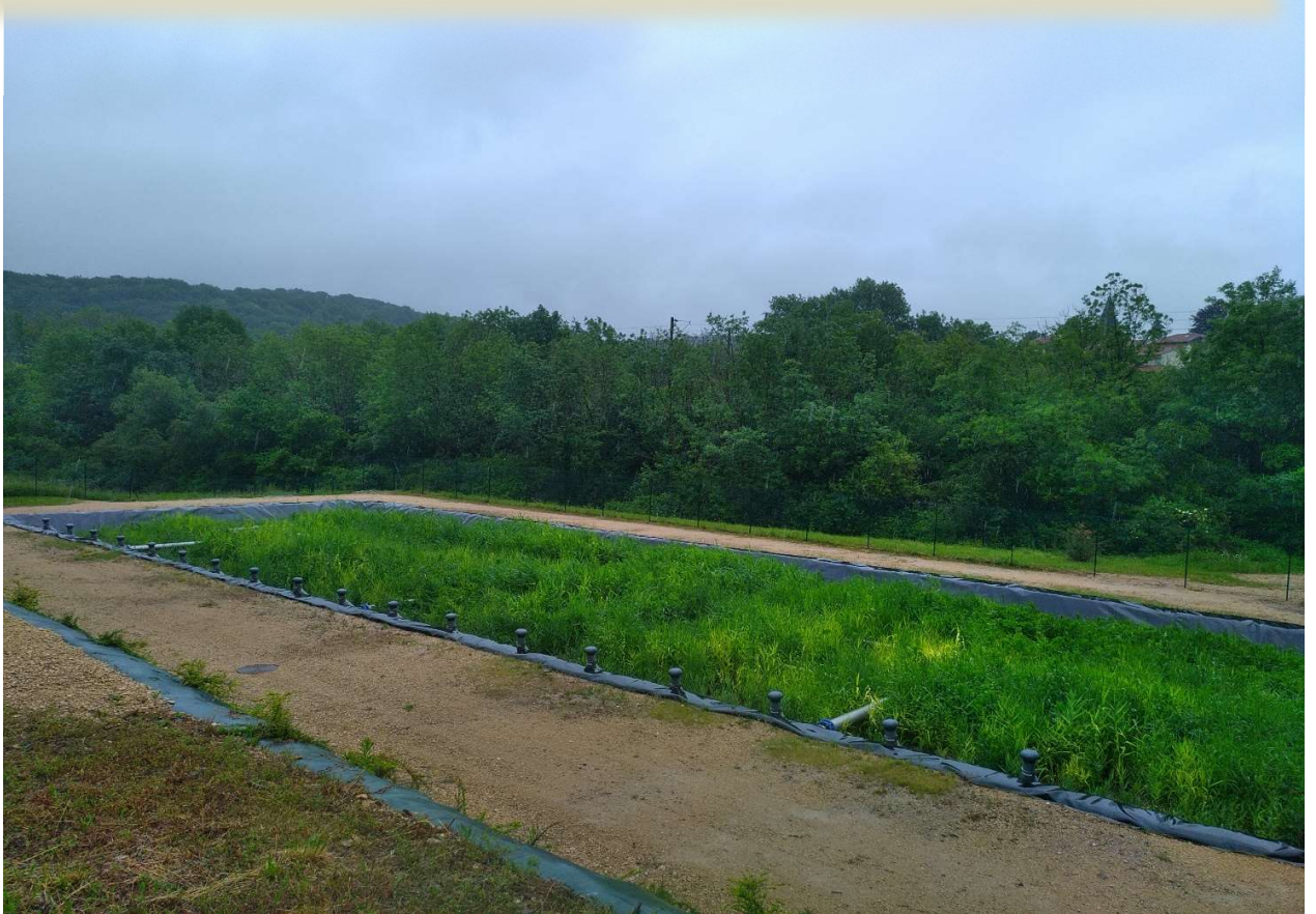
Station d'épuration des eaux usées de Jaulny 17.06.2020
